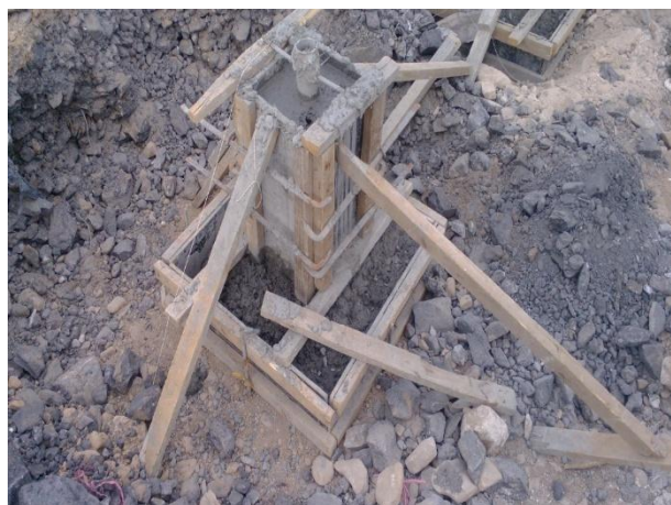
基础浇筑缺乏振动
