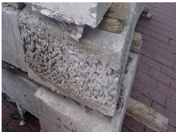
混凝土施工质量不合格，
