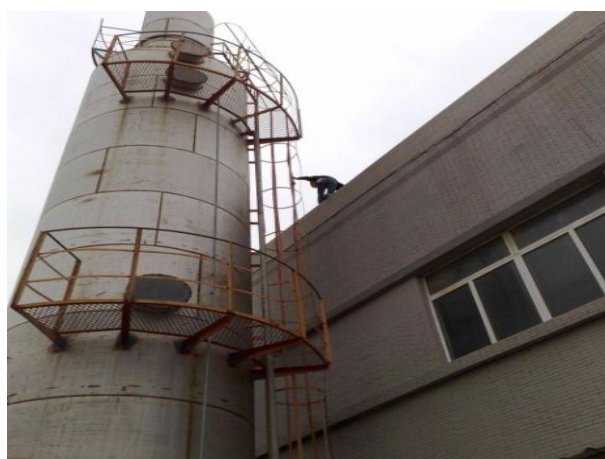
登高作业没有防护措施
