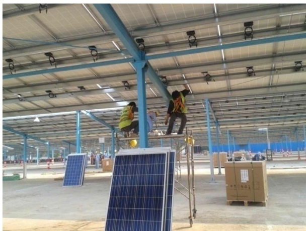
施工现场未佩戴安全帽
