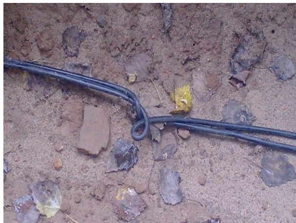
线缆打结，直埋时容易造成破损
