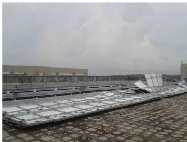
配重不到位 方阵被吹翻不合
