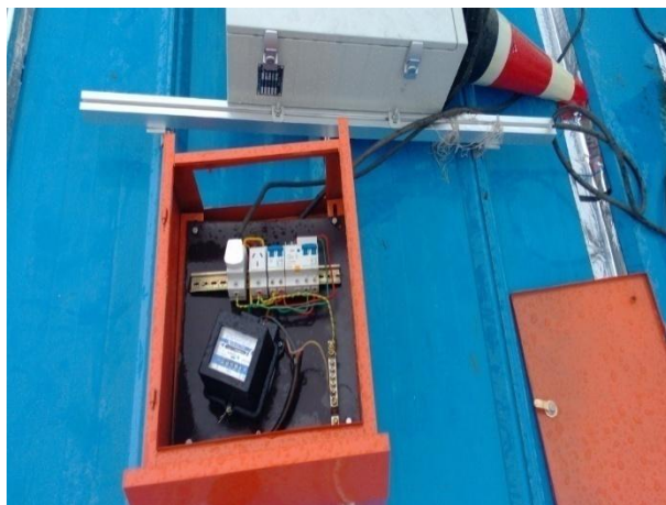
施工作业，配电箱安全等级不够
