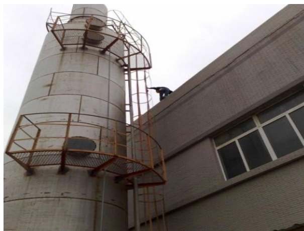
登高作业没有防护措施
