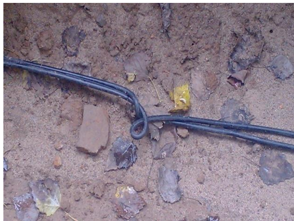
线缆打结，直埋时容易造成破损
