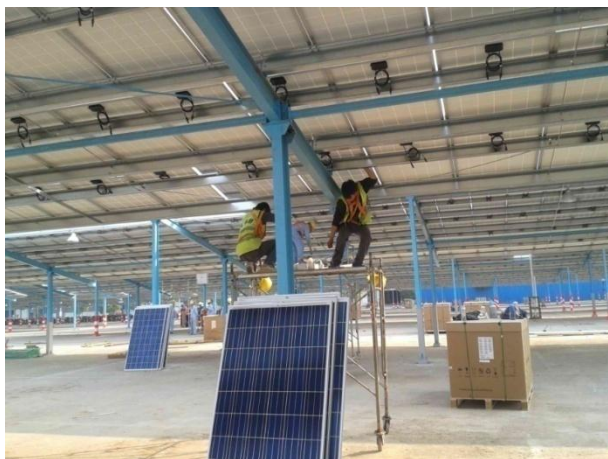
施工现场未佩戴安全帽
