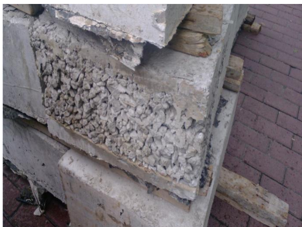
混凝土施工质量不合格，
