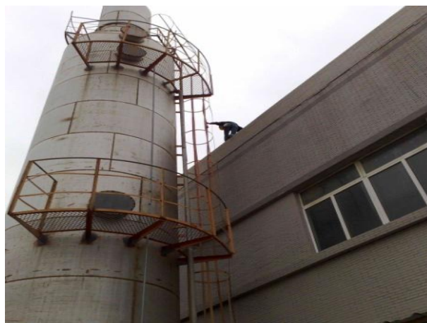
登高作业没有防护措施
