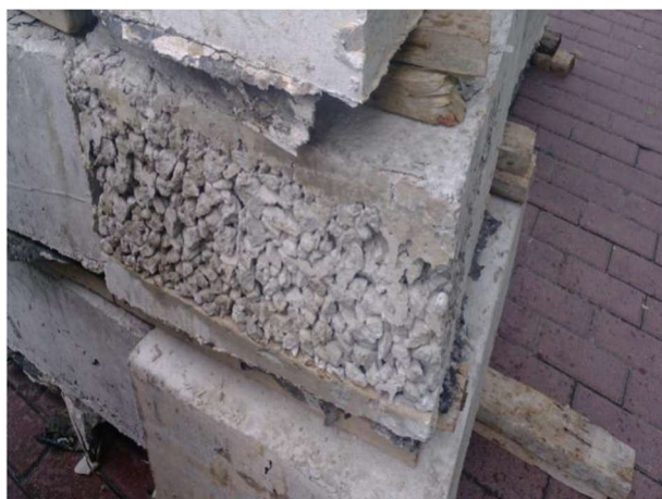
混凝土施工质量不合格，
