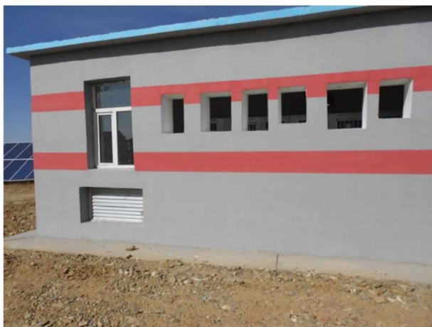
电气房，缺乏小鸟等飞禽防护，容易造成电气损坏
