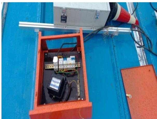
施工作业，配电箱安全等级不够
