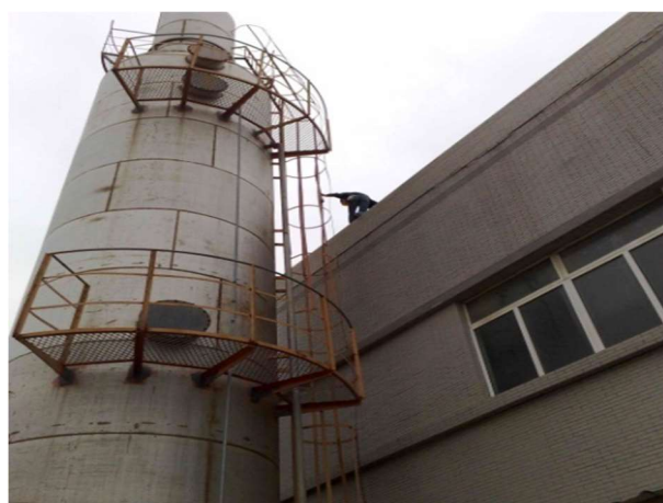
登高作业没有防护措施
