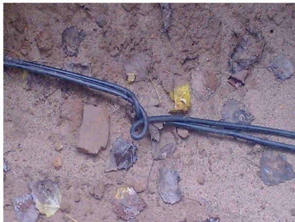
线缆打结，直埋时容易造成破损
