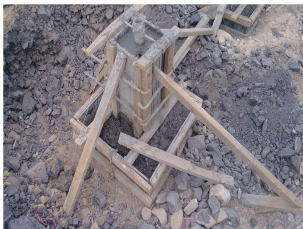
基础浇筑缺乏振动
