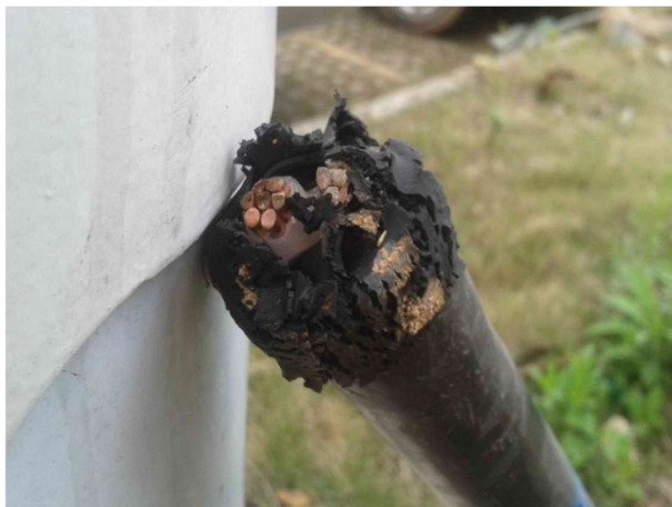
电缆端头制作工艺不合格，造成电缆头爆掉
