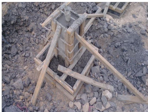
基础浇筑缺乏振动
