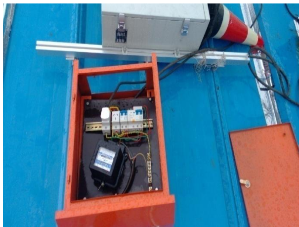
施工作业，配电箱安全等级不够
