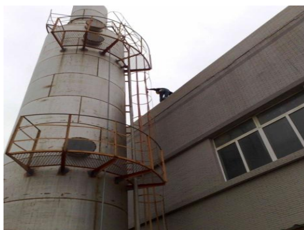
登高作业没有防护措施
