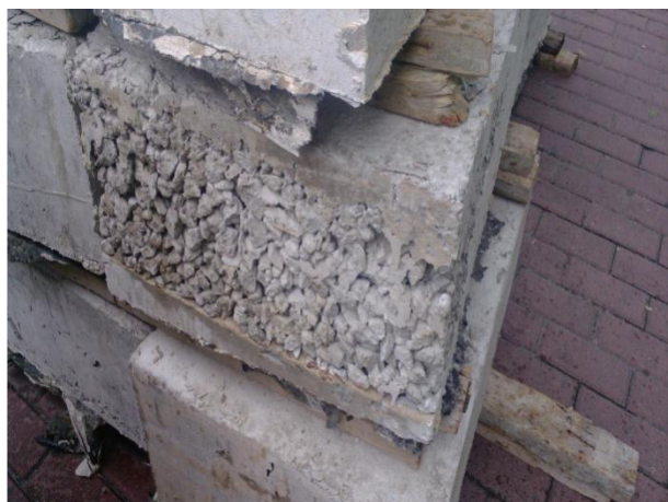
混凝土施工质量不合格，
