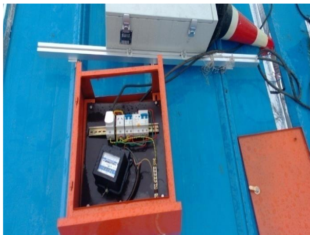
施工作业，配电箱安全等级不够
