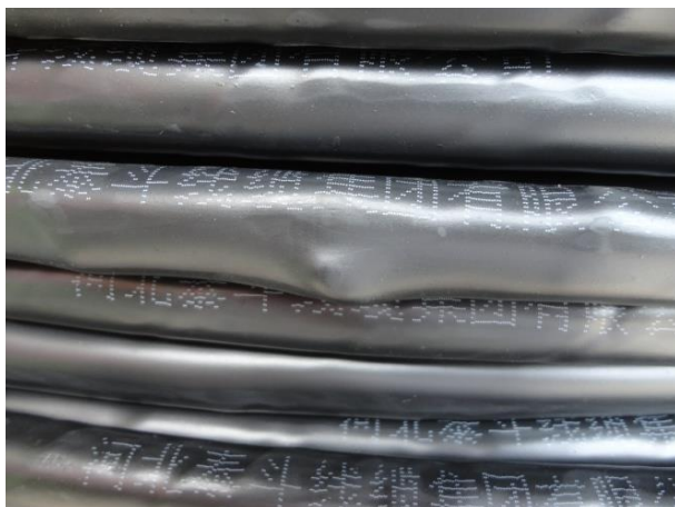
高压线缆材料中出现接头
