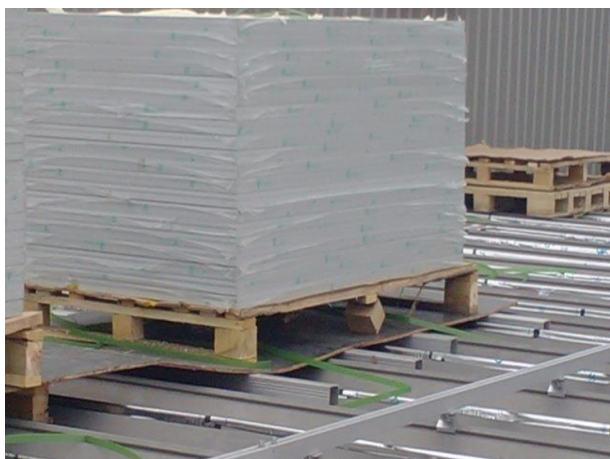
物品集中堆放，彩钢瓦屋面承重等级危险
