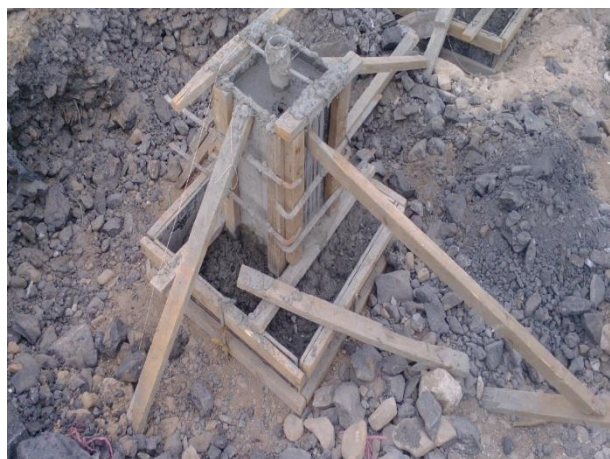
基础浇筑缺乏振动
