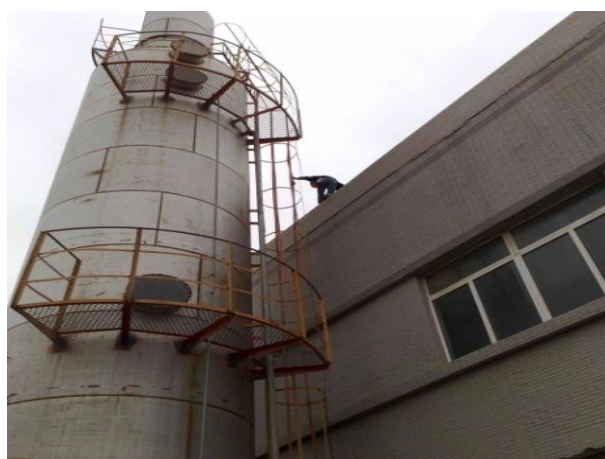
登高作业没有防护措施
