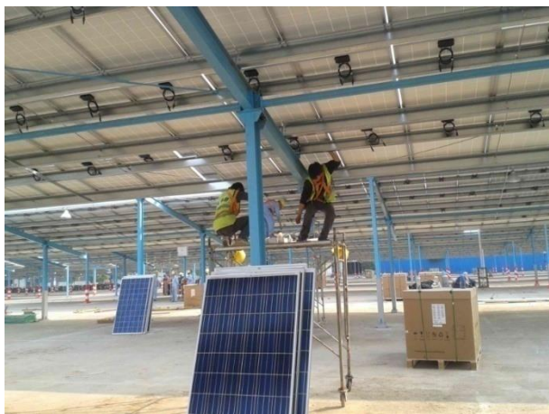
施工现场未佩戴安全帽
