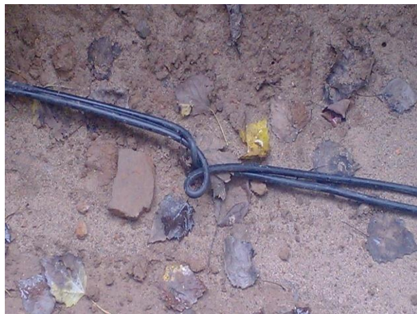
线缆打结，直埋时容易造成破损
