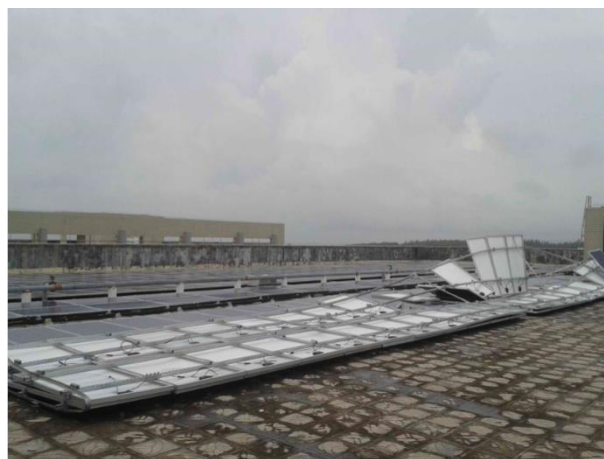
配重不到位 方阵被吹翻不合
