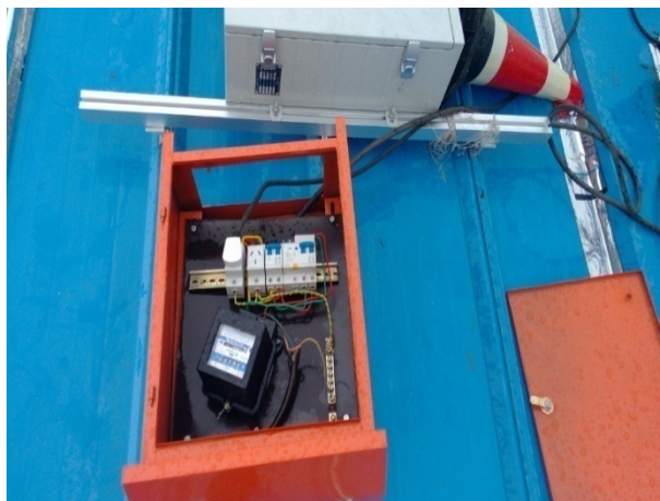
施工作业，配电箱安全等级不够
