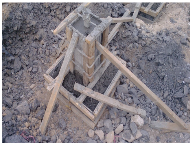
基础浇筑缺乏振动
