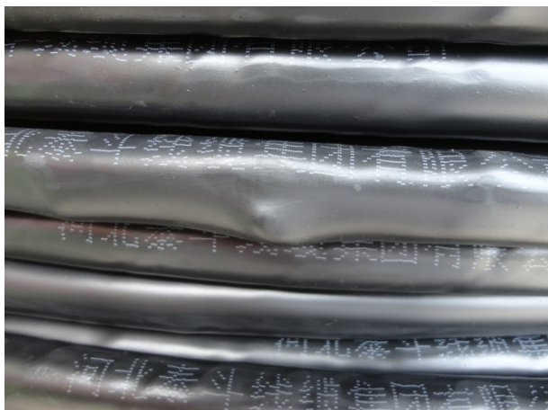
高压线缆材料中出现接头
