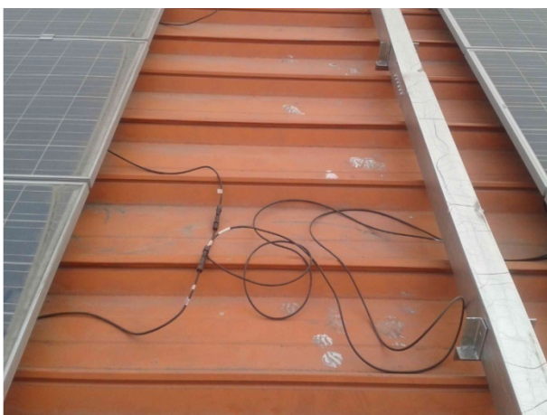
电气施工质量问题
