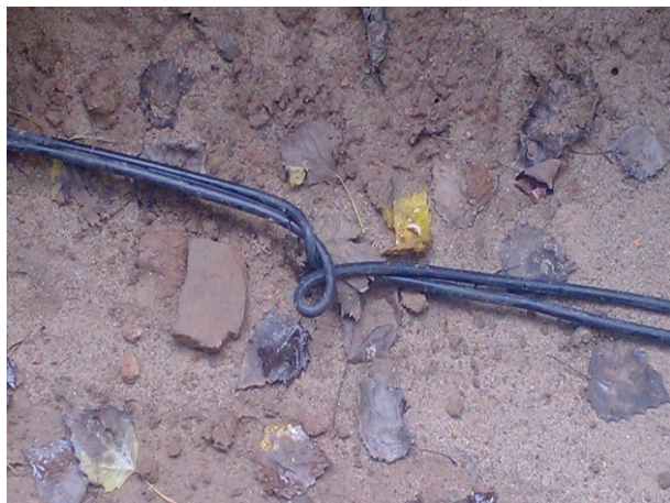
线缆打结，直埋时容易造成破损
