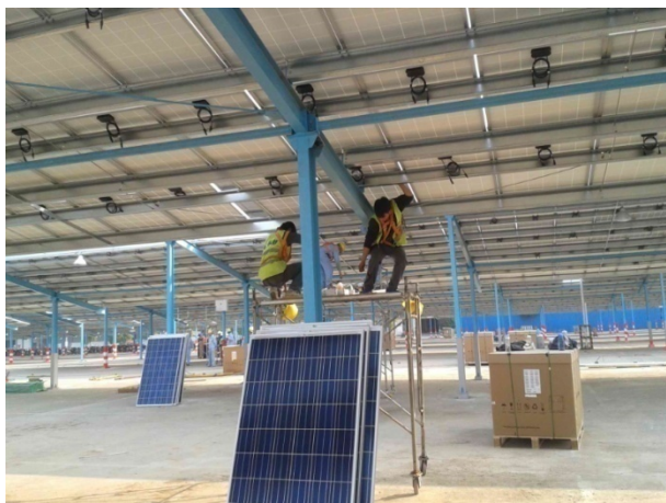
施工现场未佩戴安全帽
