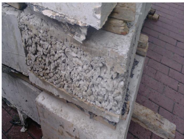
混凝土施工质量不合格，
