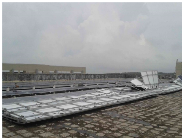
配重不到位 方阵被吹翻不合
