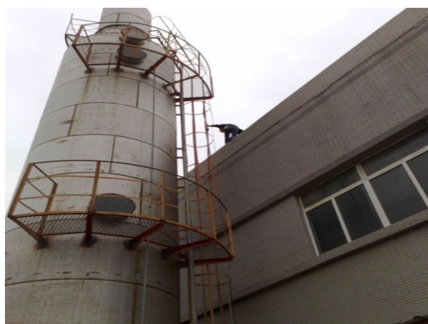
登高作业没有防护措施
