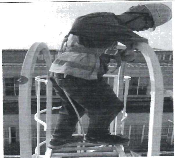
工人上下外扶梯系安全带
