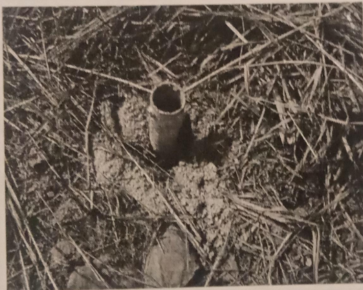
桩基不合格照片
