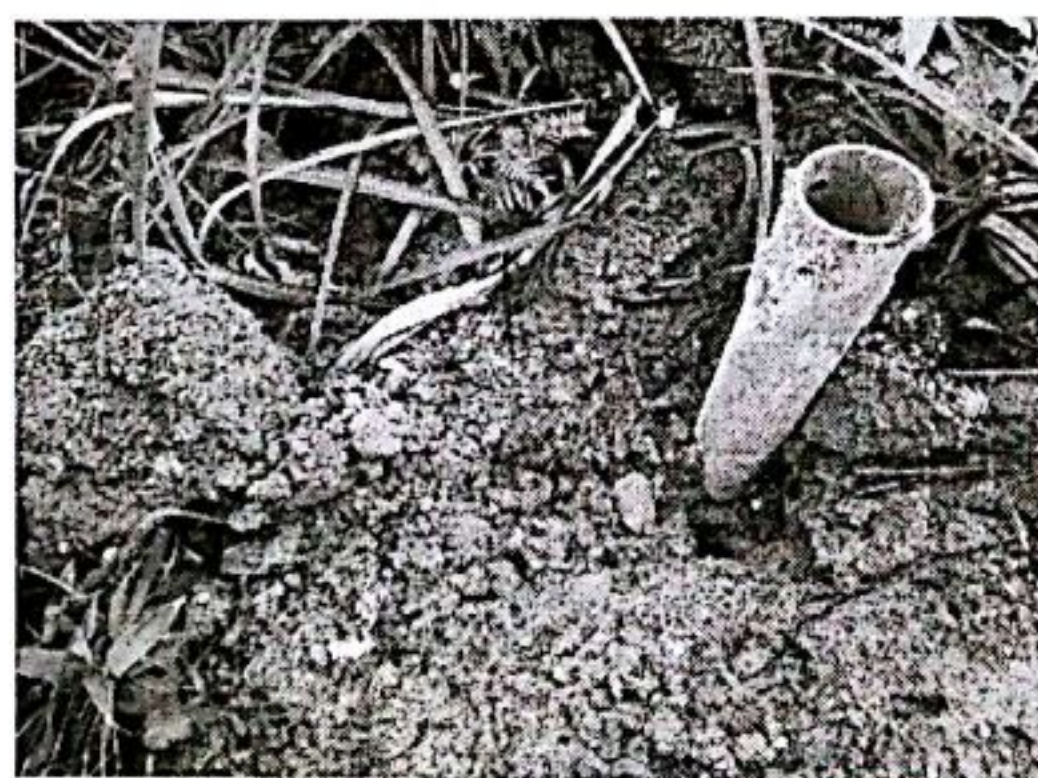
桩孔歪斜有泥土、混凝土过少
