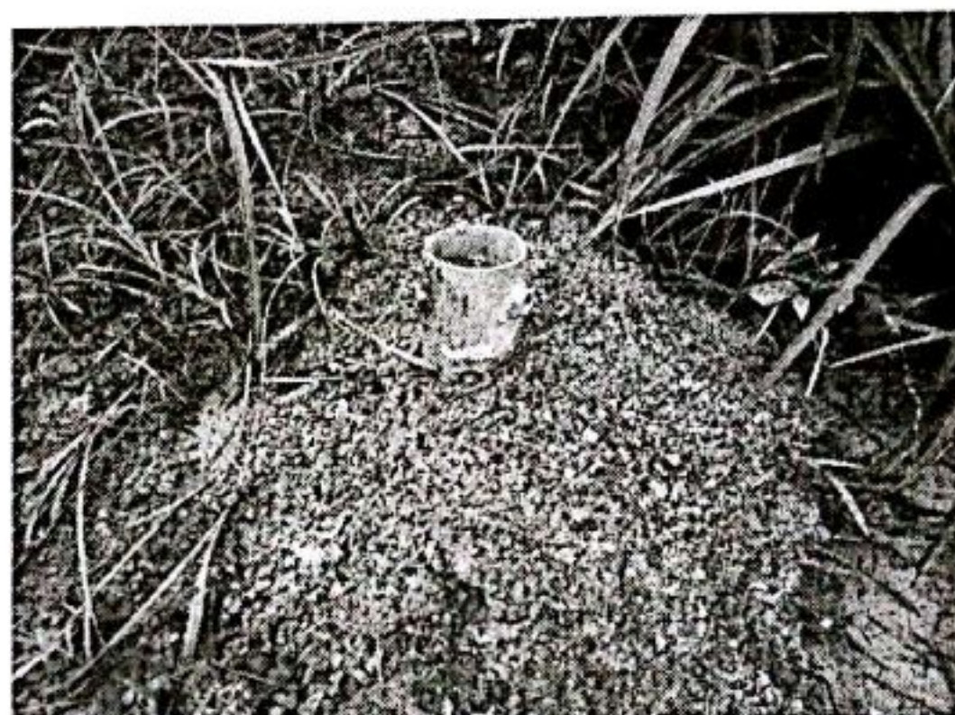
桩高度偏低、混凝土露砂、未抹平
