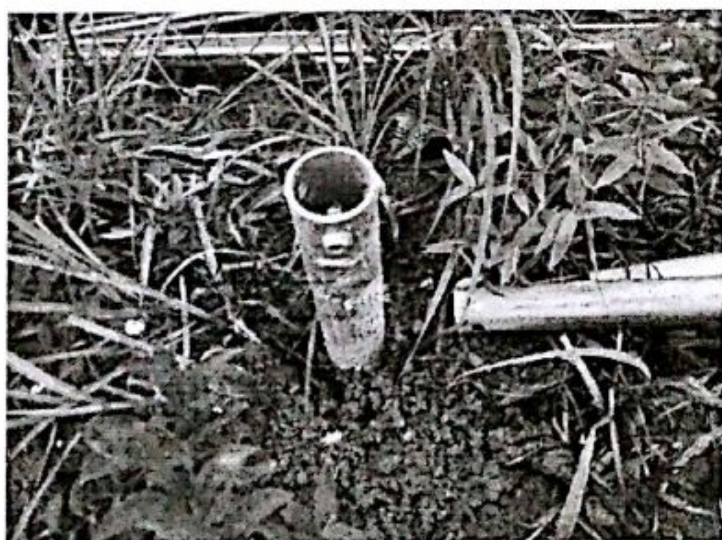
桩歪斜、混凝土过少
