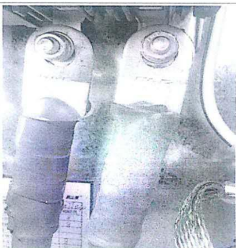
电缆终端孔径与断路器端子螺栓不匹配，搭接面积过少
