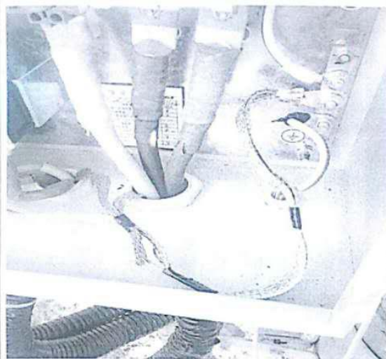
接地线未直接接于地排，采用胶带绑与其它两根地线上
