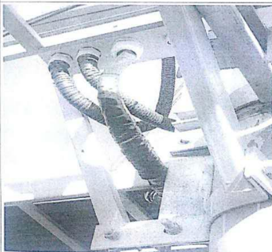
波纹管损坏严重，一部分电缆外用胶带代替波纹管
