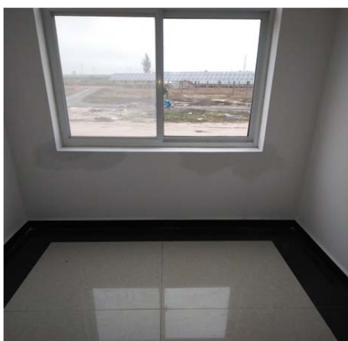
综合楼走廊窗户渗水
