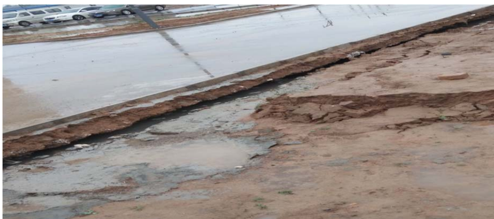
消防水池四周及砼路面底下下沉
