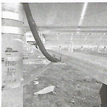
电缆预留过紧
