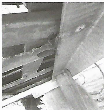
桥架防腐不到位
