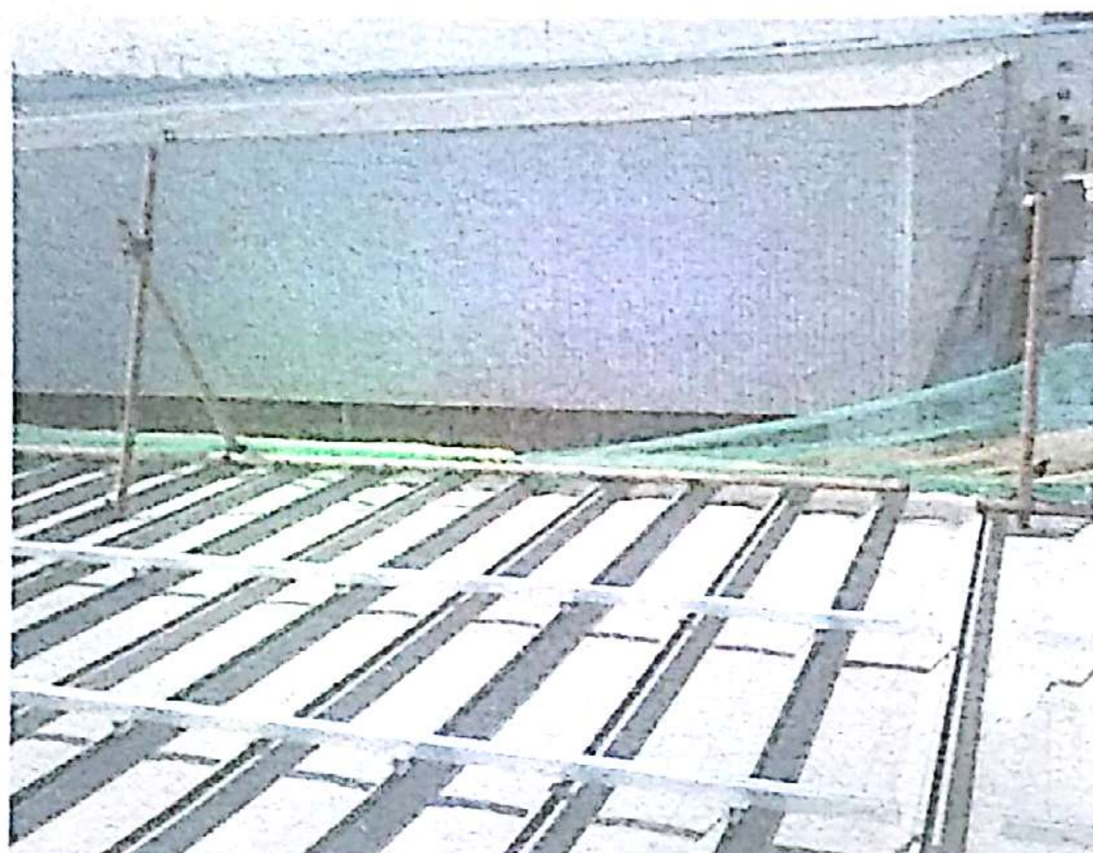
临边防护安全网脱落
