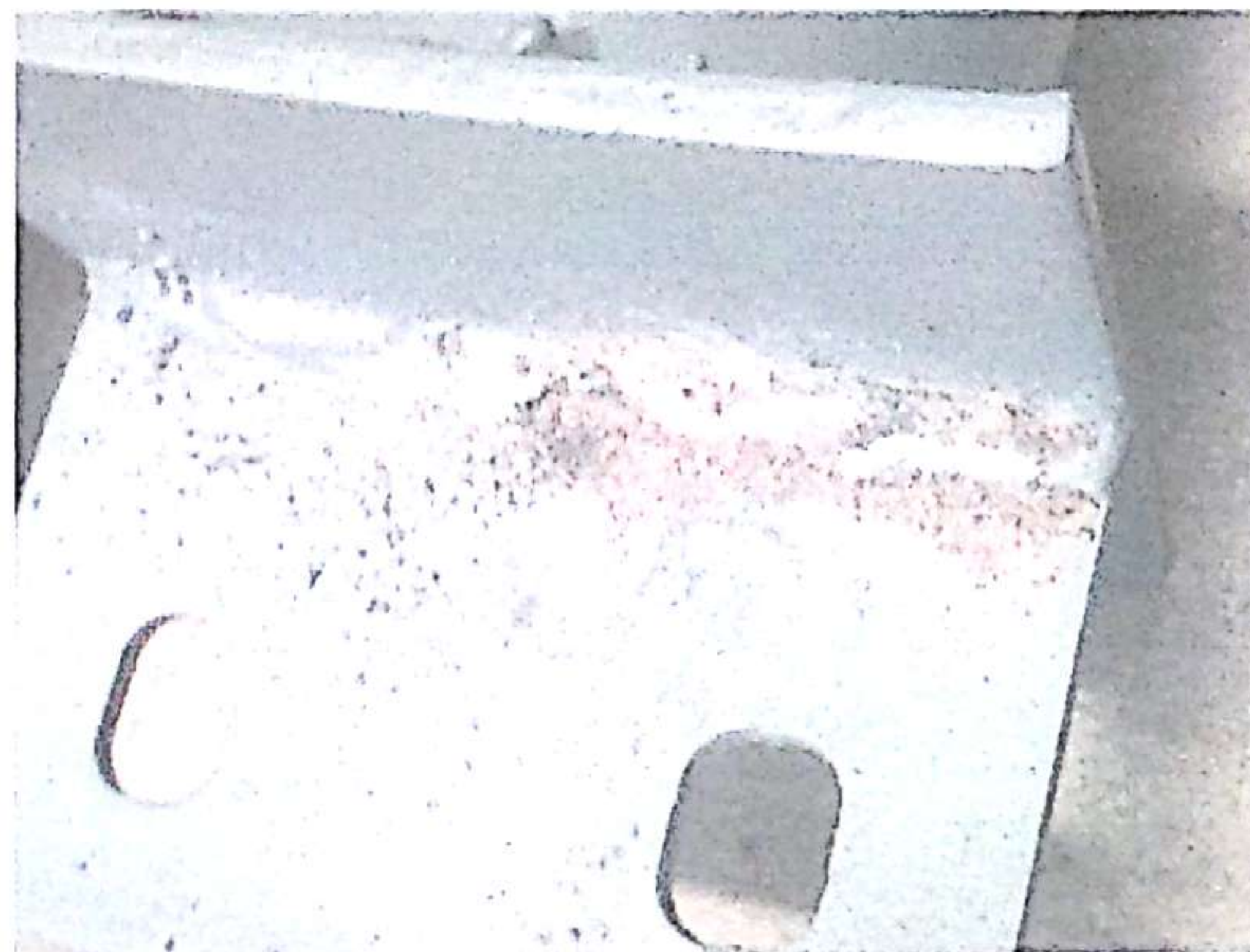
防腐前焊渣未清理
