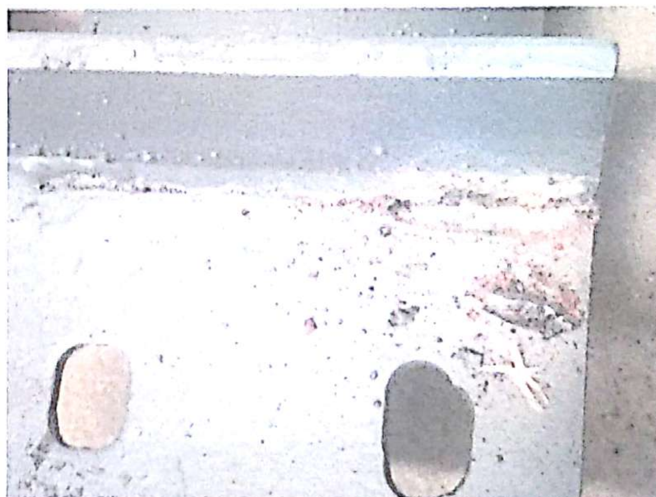
防腐前焊渣未清理
