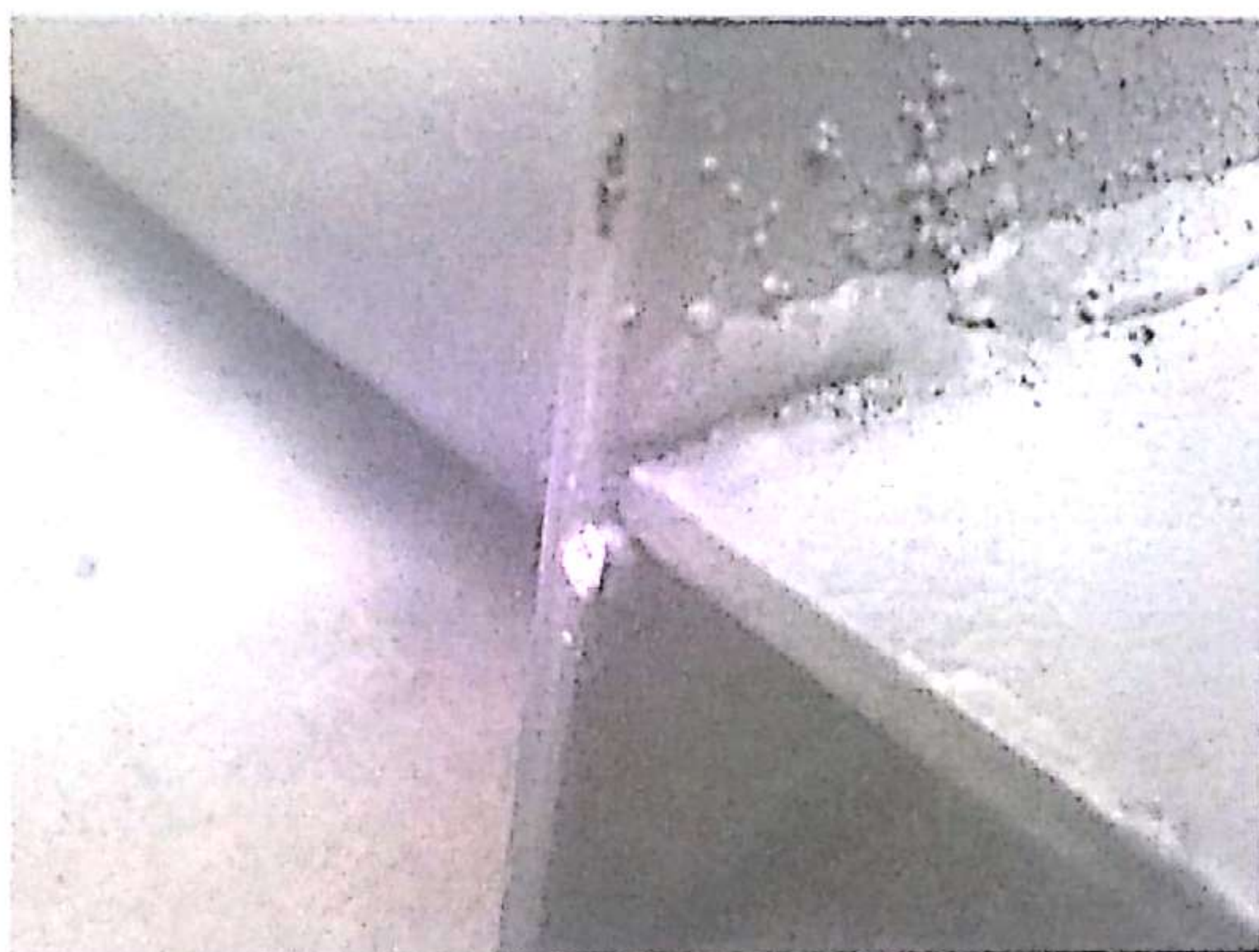
防腐涂刷不充分
