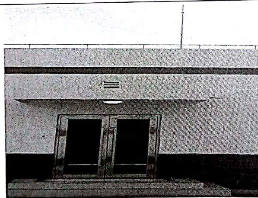
北侧百叶窗口下雨时雨水渗漏
