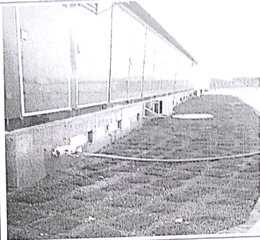
舱底路面没有阴井排水口
