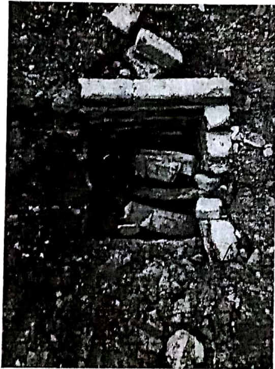
三期电缆井破损
