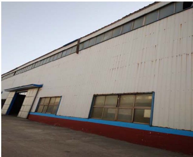
屋檐包边悬挂、未修复、存在安全隐患
