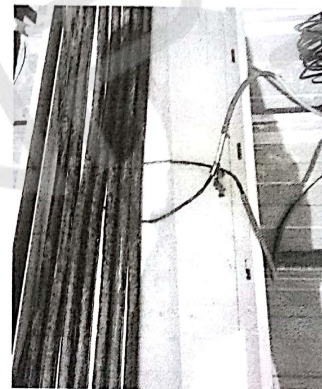
通信线缆损坏
