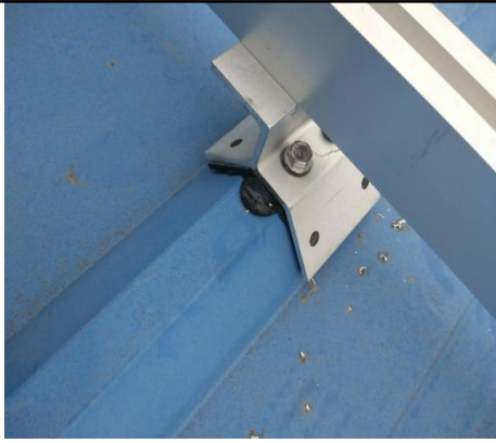
5. 施工过程中产生的垃圾未进行清理
