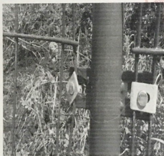
围网螺栓未紧固
