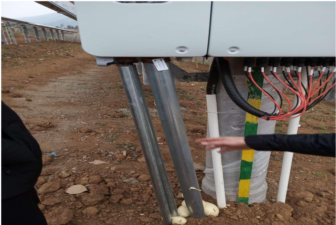
逆变器下方电缆管不垂直、不牢靠
