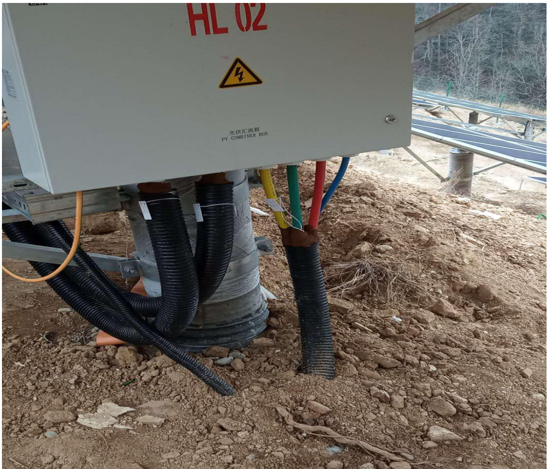
部分汇流箱交流电缆地埋未穿钢管
