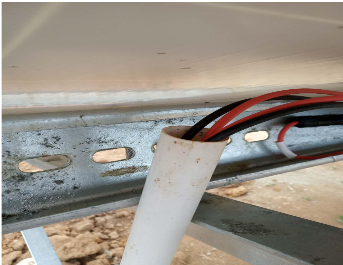
电缆管口未封堵
