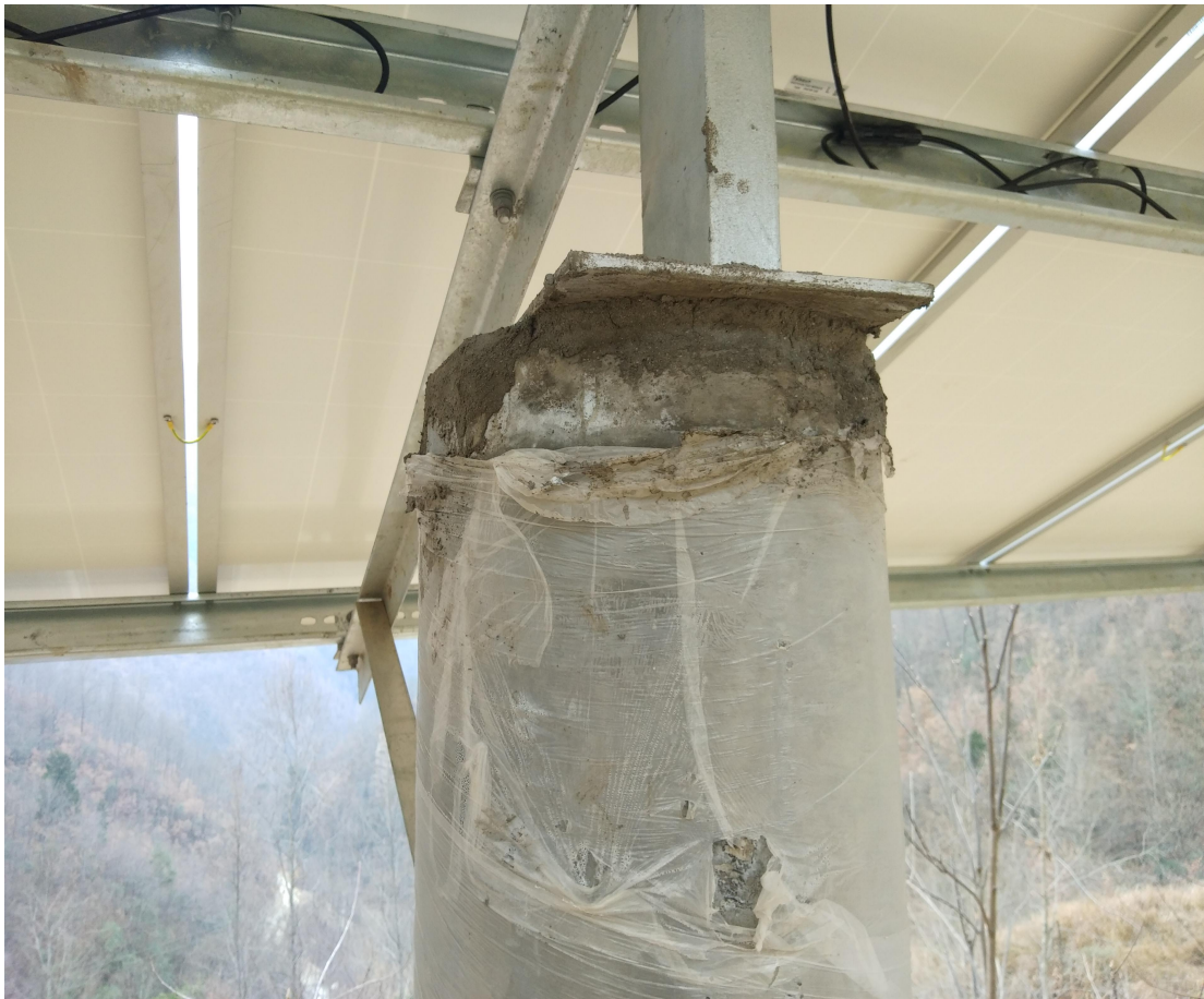
立柱未焊于桩中心、偏差太大
