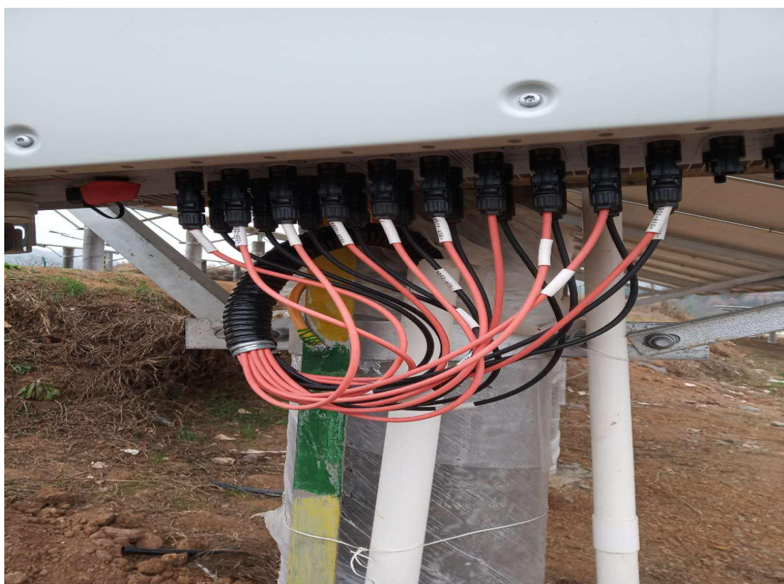
逆变器直流电缆正负极未分开穿管、电缆交叉
