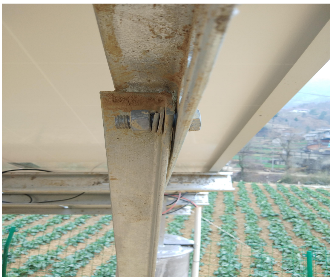
部分螺栓未紧固
