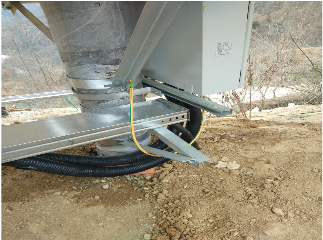
汇流箱接地未接主接地网、安装高度不符合规范（详见电气安装规范-配电箱安装要求）
