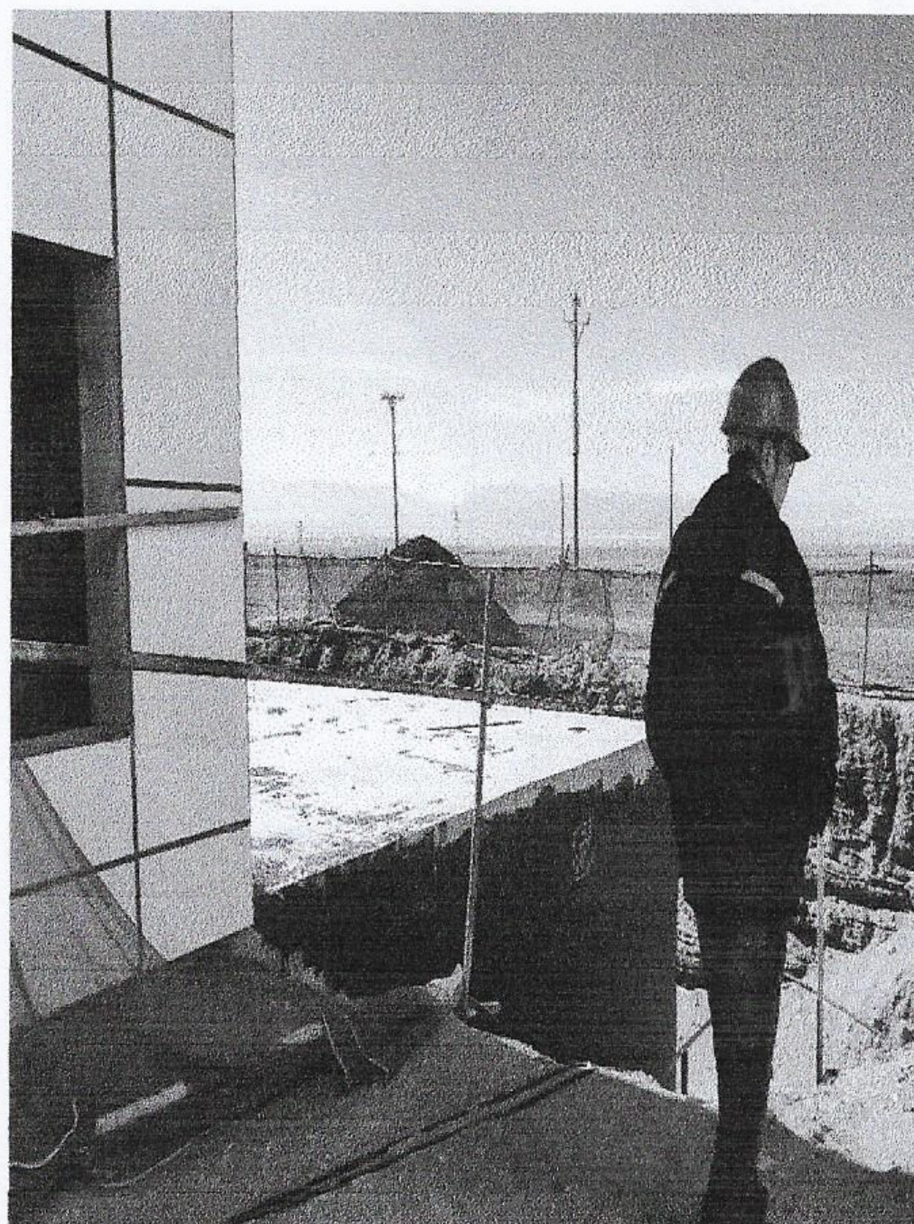
水泵房基坑未做安全防护围栏
