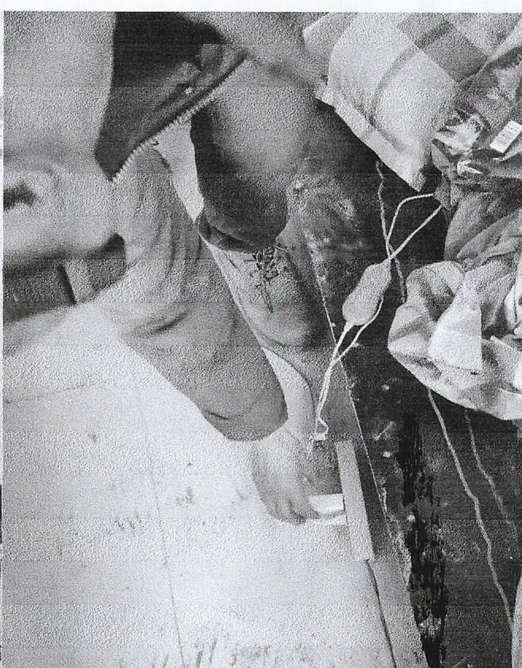
施工人员住宿区用电不规范，电热毯电源未断电
