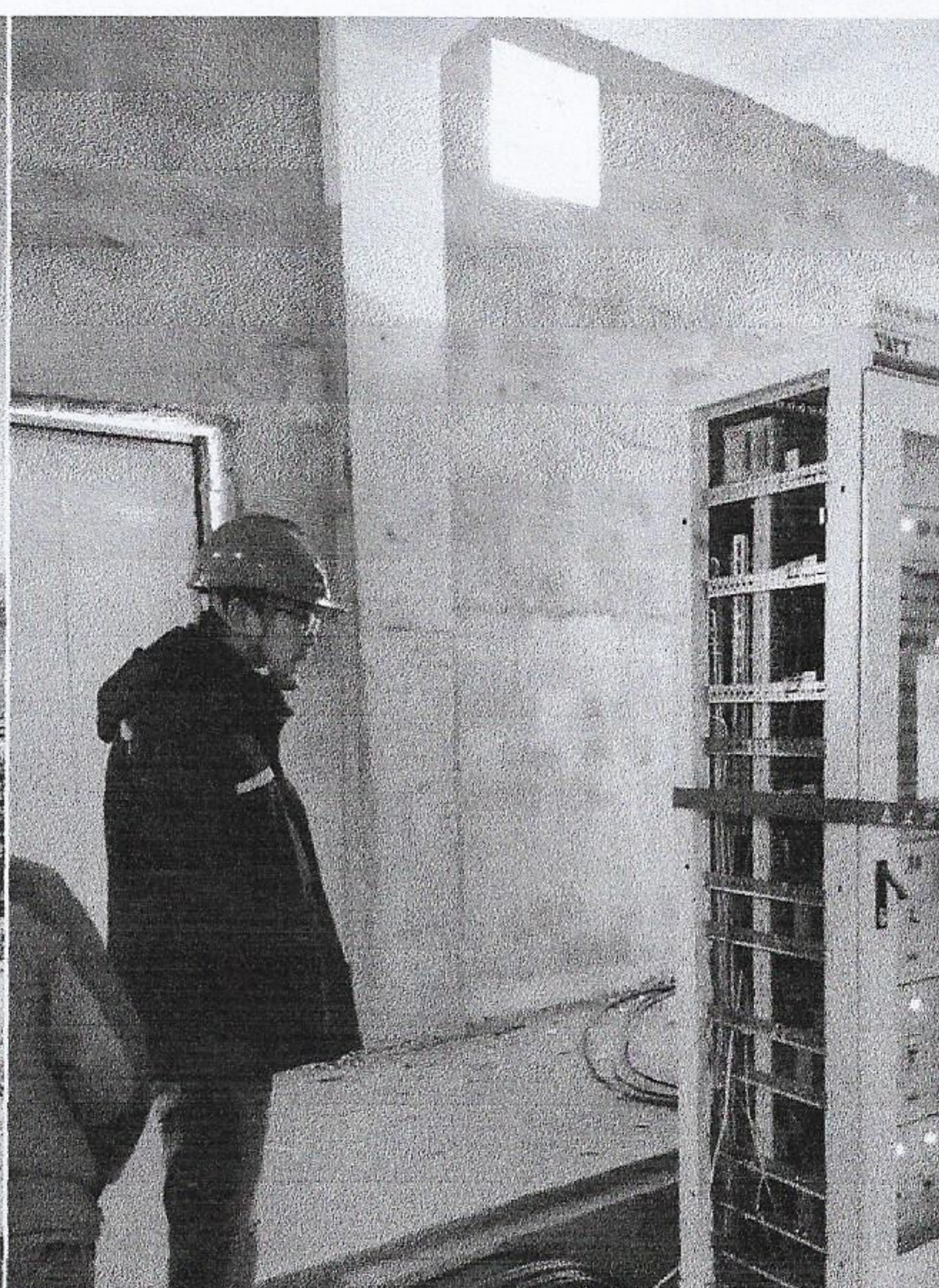
一次侧室带电设备侧板未安装
