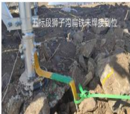
接地扁铁未焊接到位
