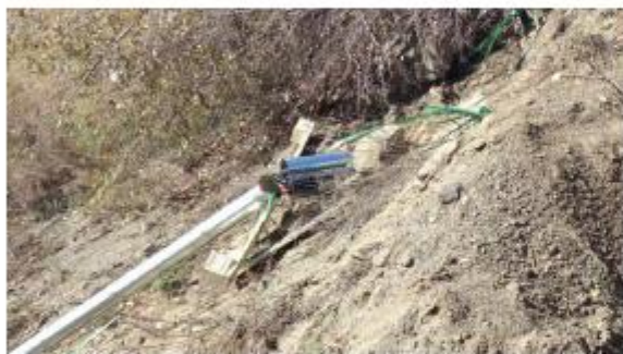
电缆接口处未做密封处理
