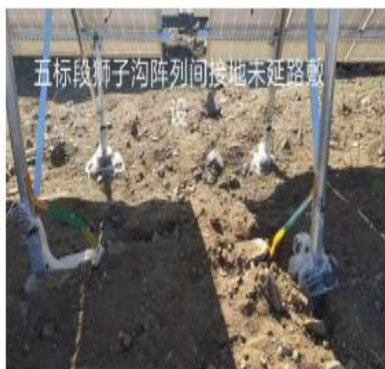
阵列间接地未沿路敷设
