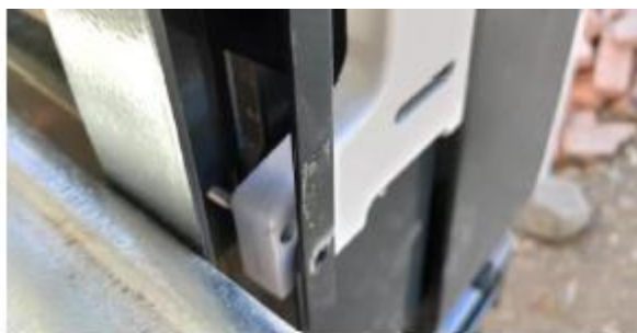
逆变器紧固螺丝未到位
