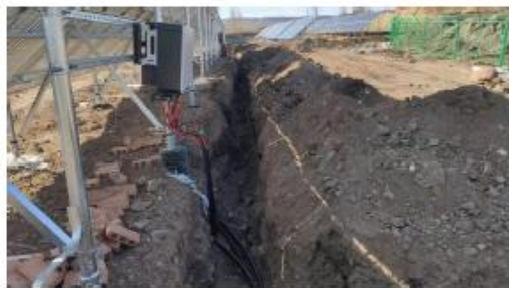
电缆沟开挖深度未达标
