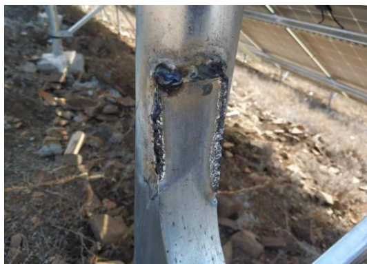
2、个别接地扁铁焊接未做防腐处理
