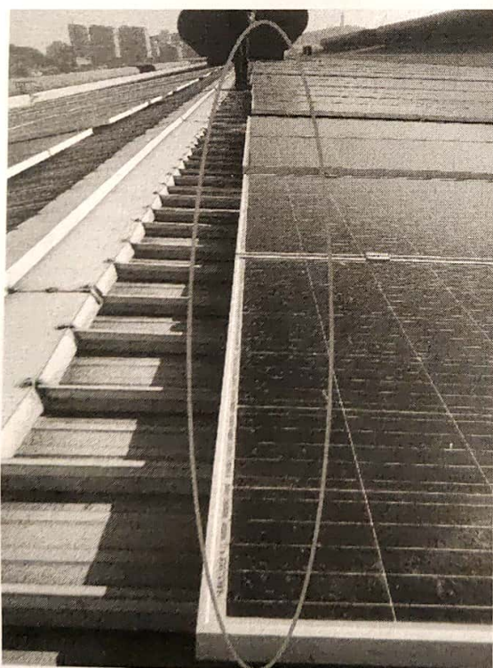
图 3：组件边沿安装不在同一条直线上
