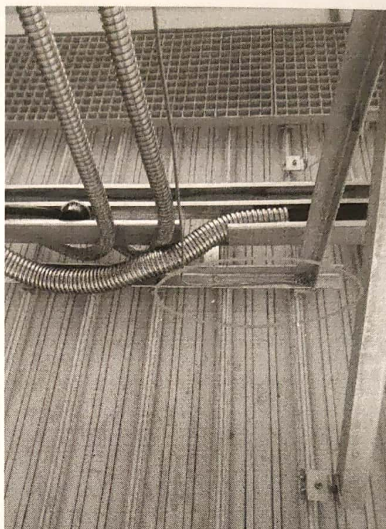
图 2：逆变器接地不规范，应接主接地网上。
