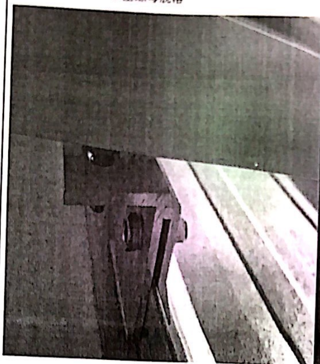
T型螺母脱落
