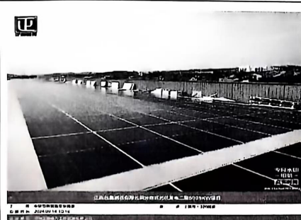
现场检查问题 (屋面垃圾清理)
