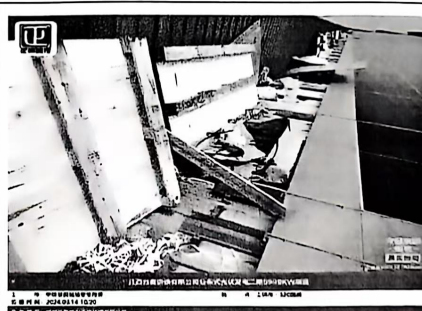
现场检查问题 (屋面垃圾)
