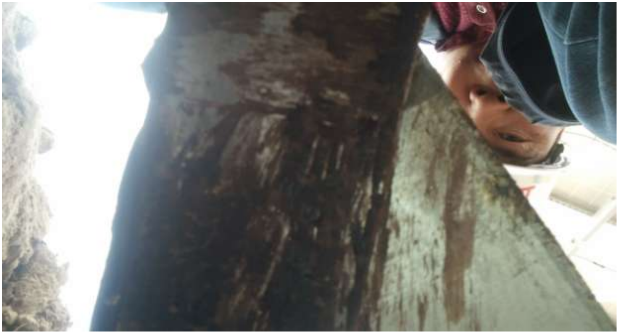
焊口背面防腐不到位
