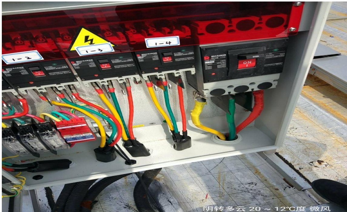
汇流箱内部未用防火泥封堵
