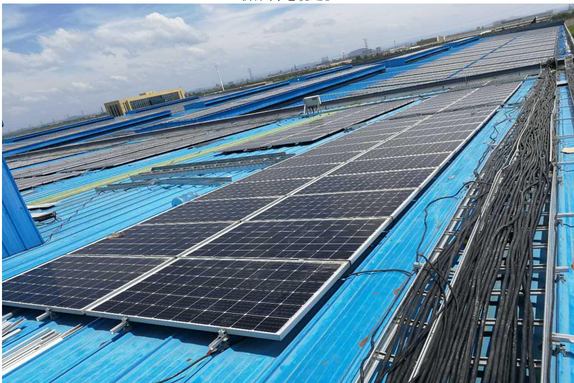
桥架内电缆过多
