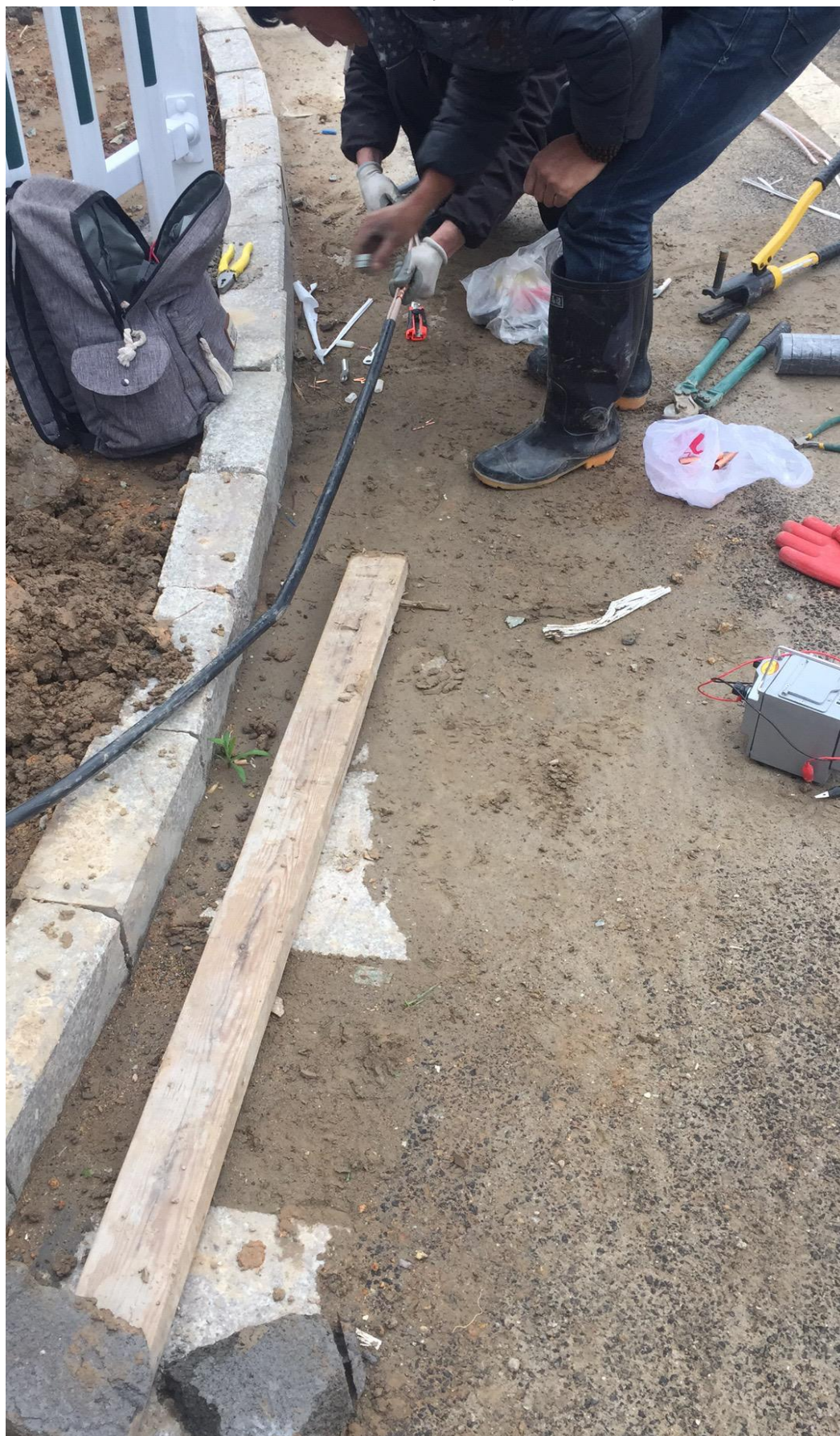
现场残缺电缆对接使用
