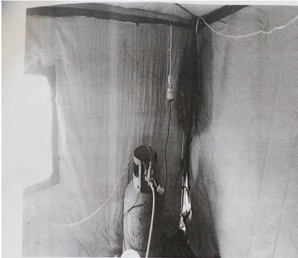
附件: JXM7-JLT01-004 (1) 电缆线随意乱接乱拉, 且紧挨煤气罐
