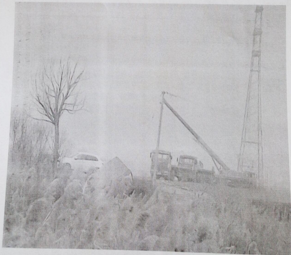
吊桩距高压线过近
