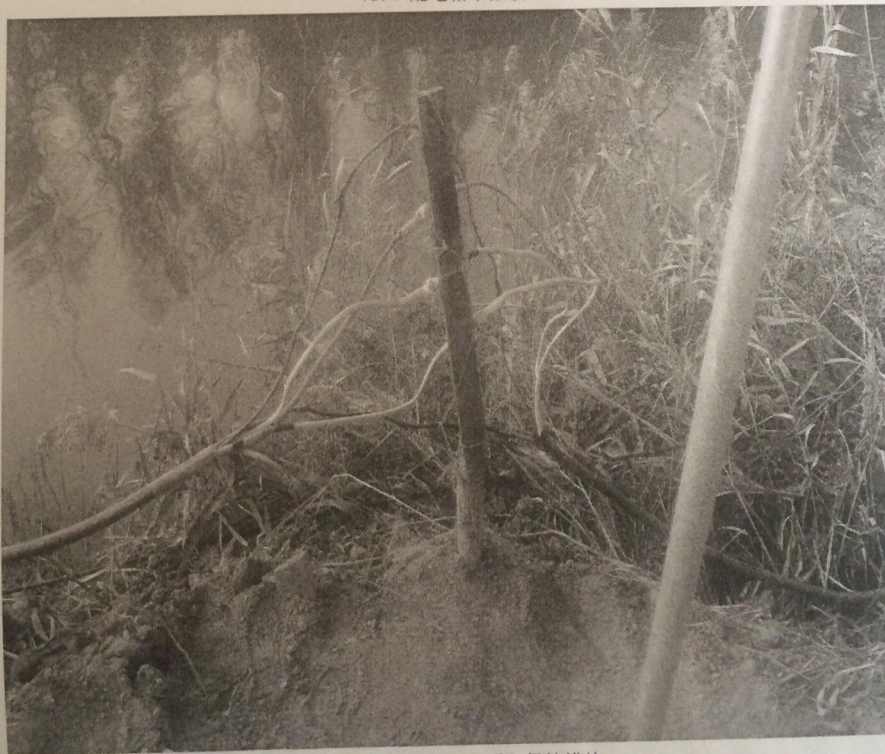
(2)、电缆线裸露，未采取保护措施 整改前
