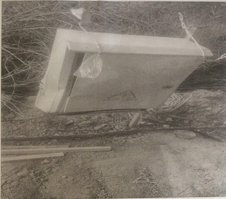
(1)、配电箱未做接地
