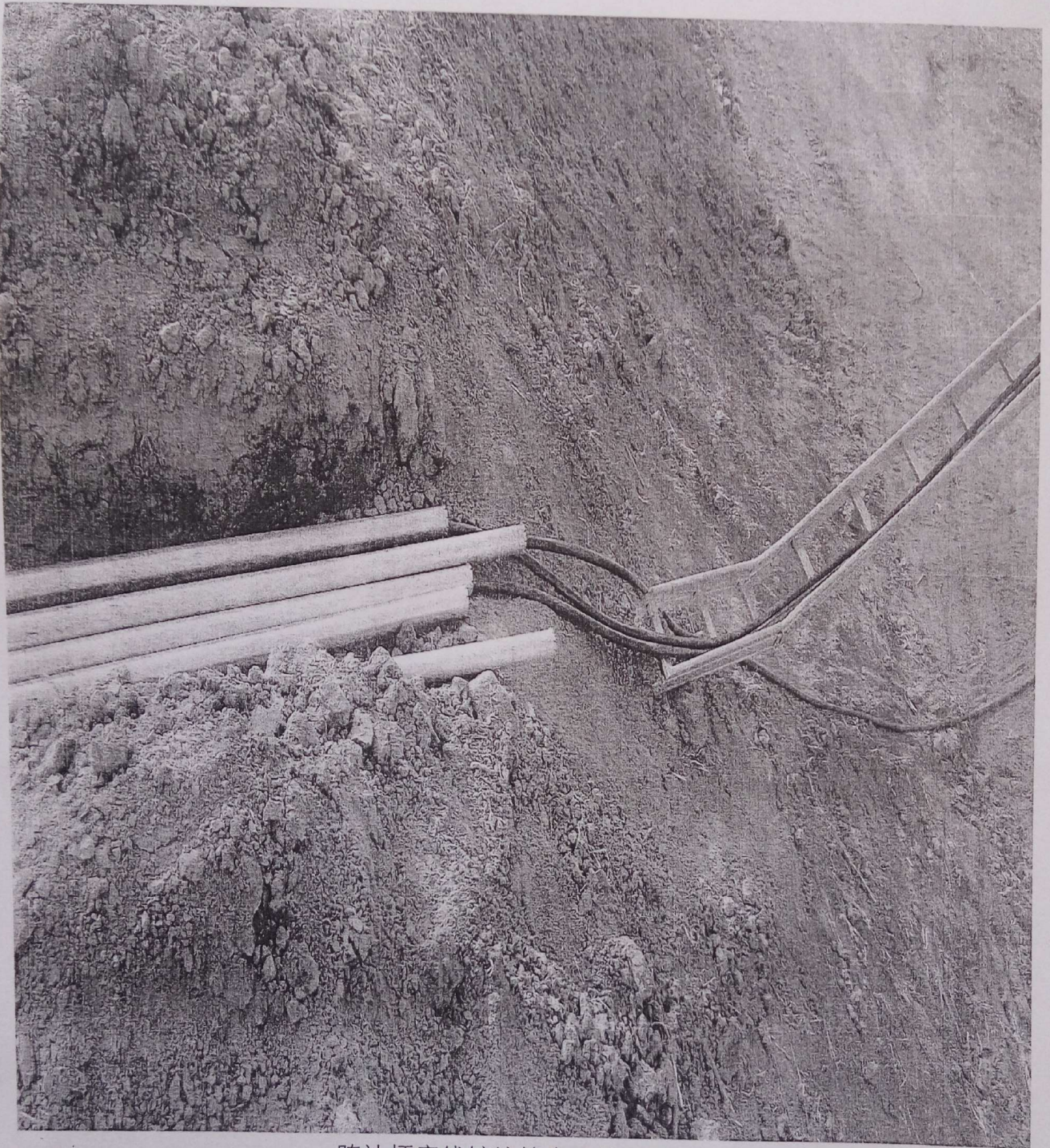
跨池梗穿线镀锌管未延伸至桥架内
