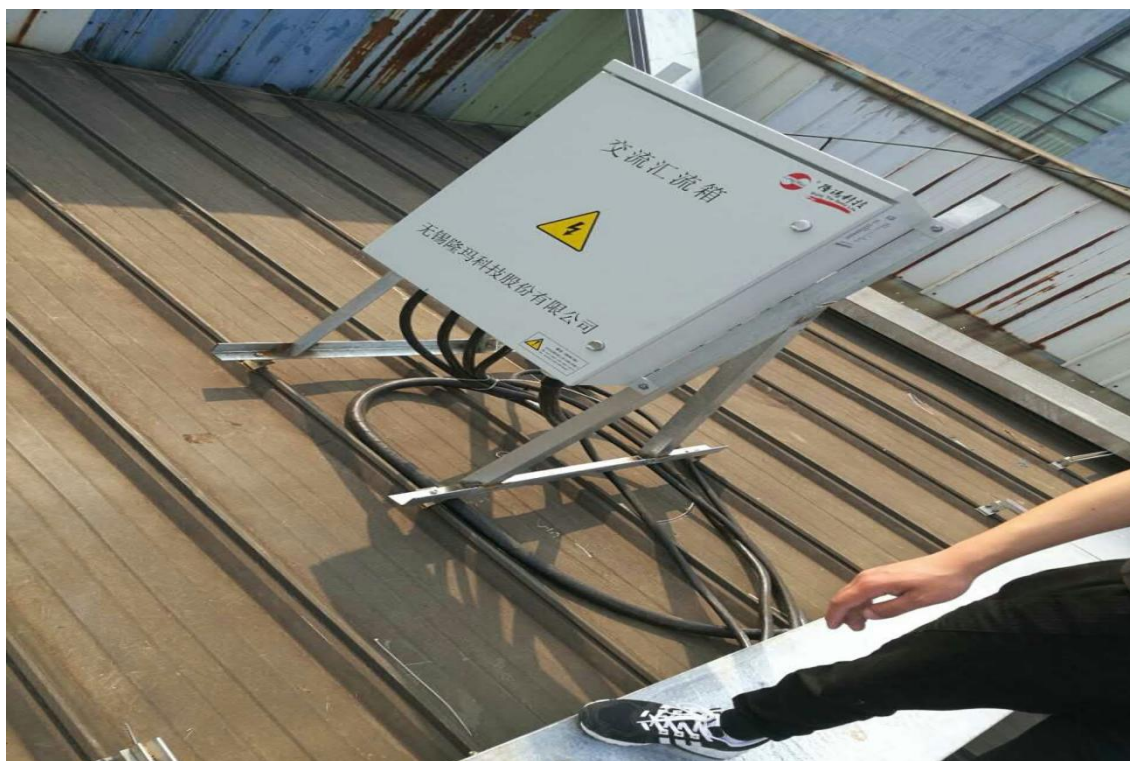
汇流箱进线、出线未套软管
