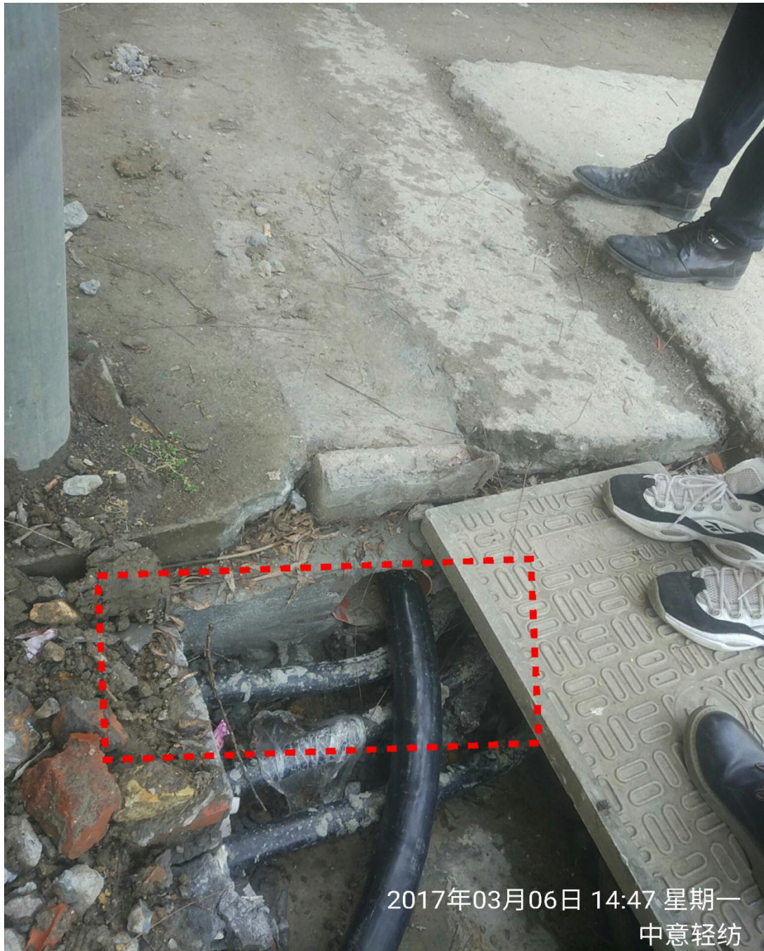
电缆过路穿管未采用镀锌钢管
