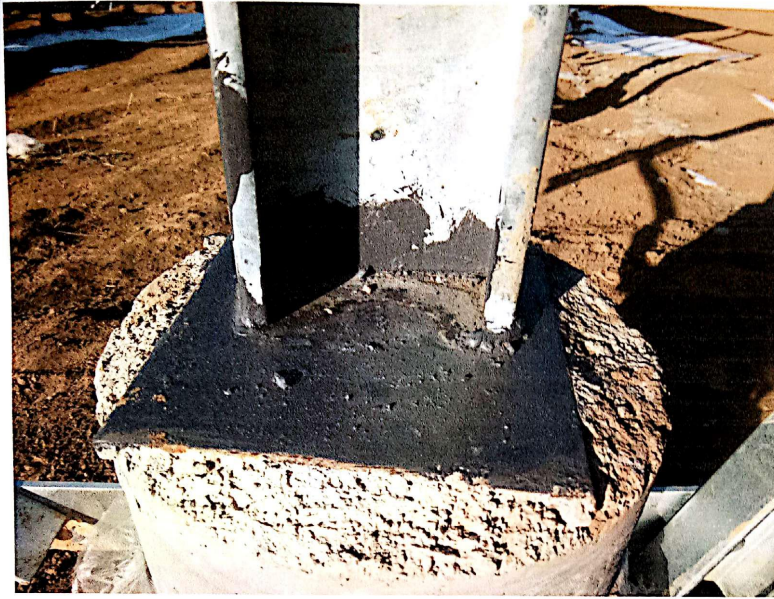
立柱焊接不牢固，未满焊。
