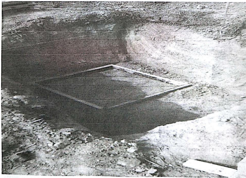
3:7 灰土未经换填，直接支模板。
