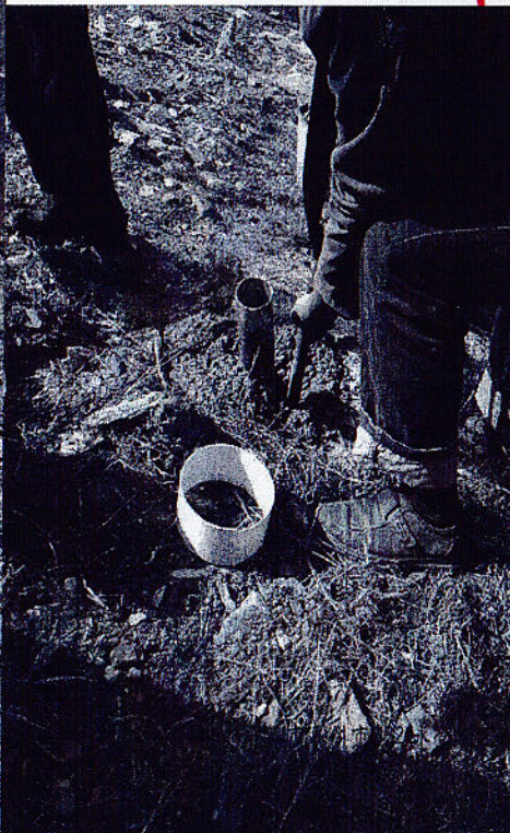
施工人员未佩戴安全手套与安全帽
