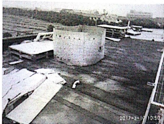
施工垃圾未清理
