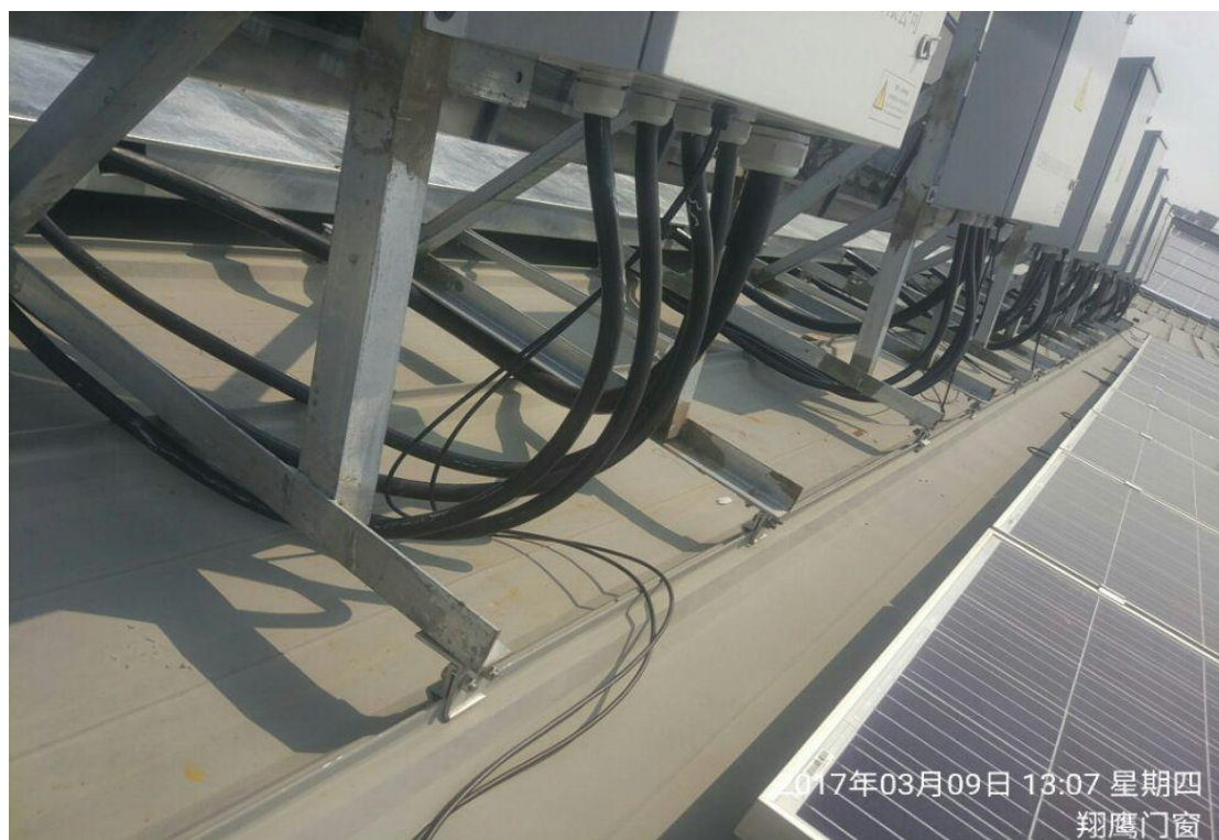
汇流箱进线及出线电缆未采取套管保护
