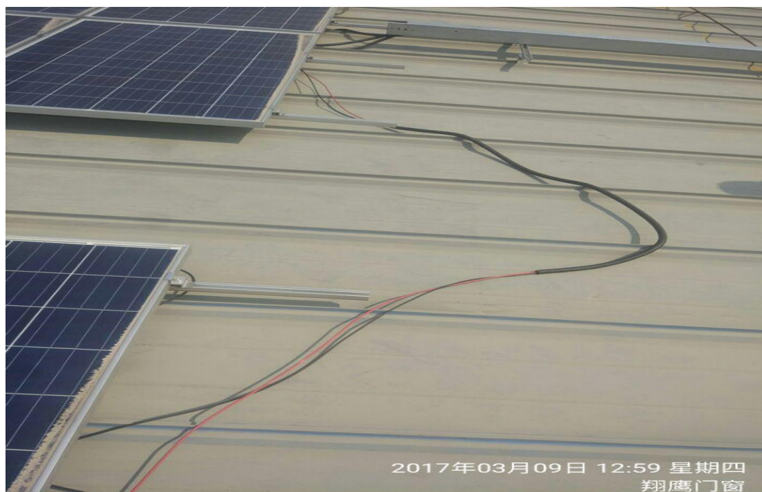
组串间走线保护管不到位
