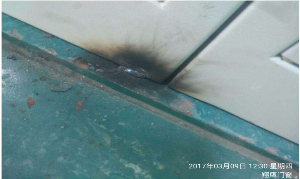
焊渣及防腐未处理
