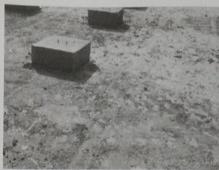
屋面混凝土残留
