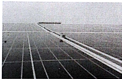
（组件压块未紧固）
