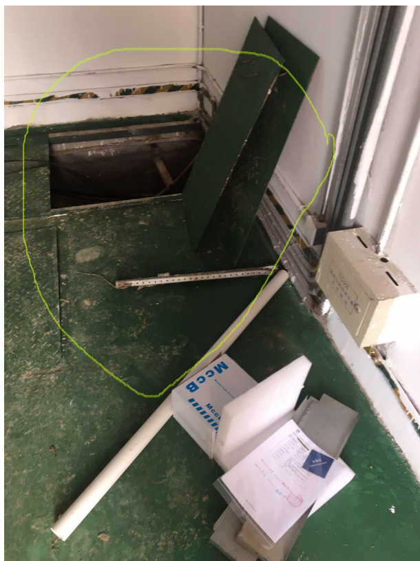
逆变室电缆盖板
