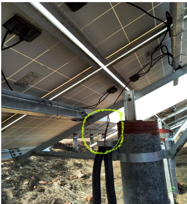
直流电缆套管遗漏
