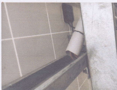
14、部份箱逆变设备上通信线缆未做防火泥。
