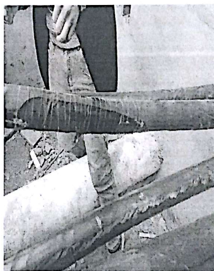
电缆造成损伤
