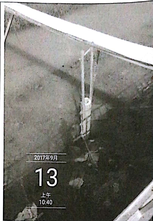
19#塘桥架桩断裂
