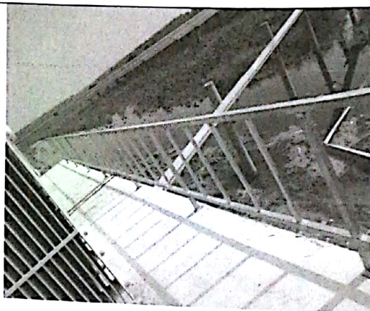
箱变围栏未接地
