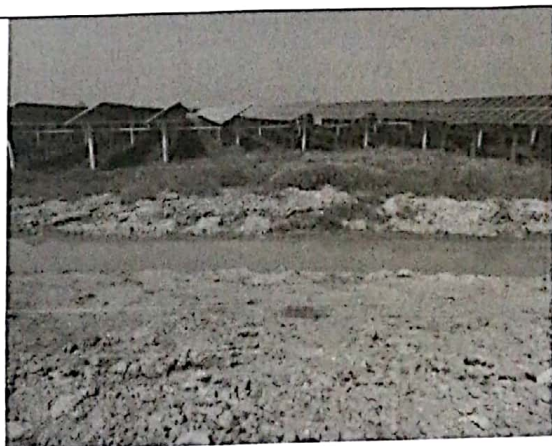
20#塘东侧环沟宽度不足
