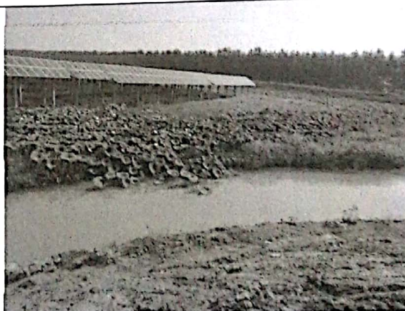
22#塘南侧环沟宽度不足
