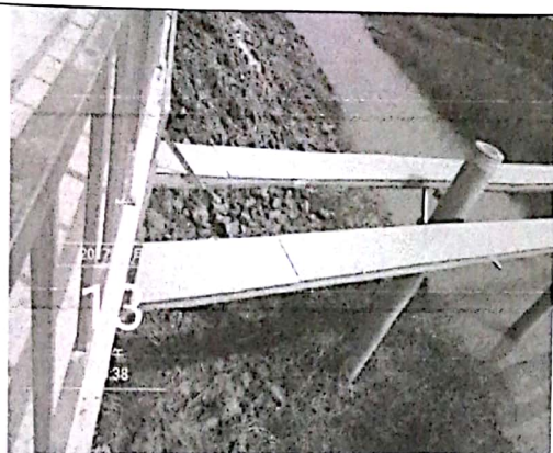
21#塘桥架一侧未接地
