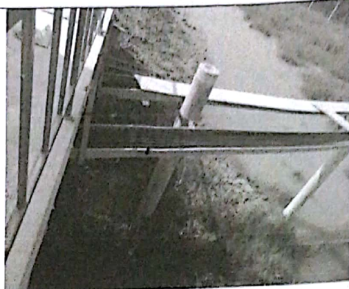
20#塘一侧桥架未接地
