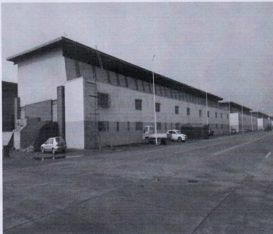
屋顶没有临边防护，脚手架无任何安全警示标示。
