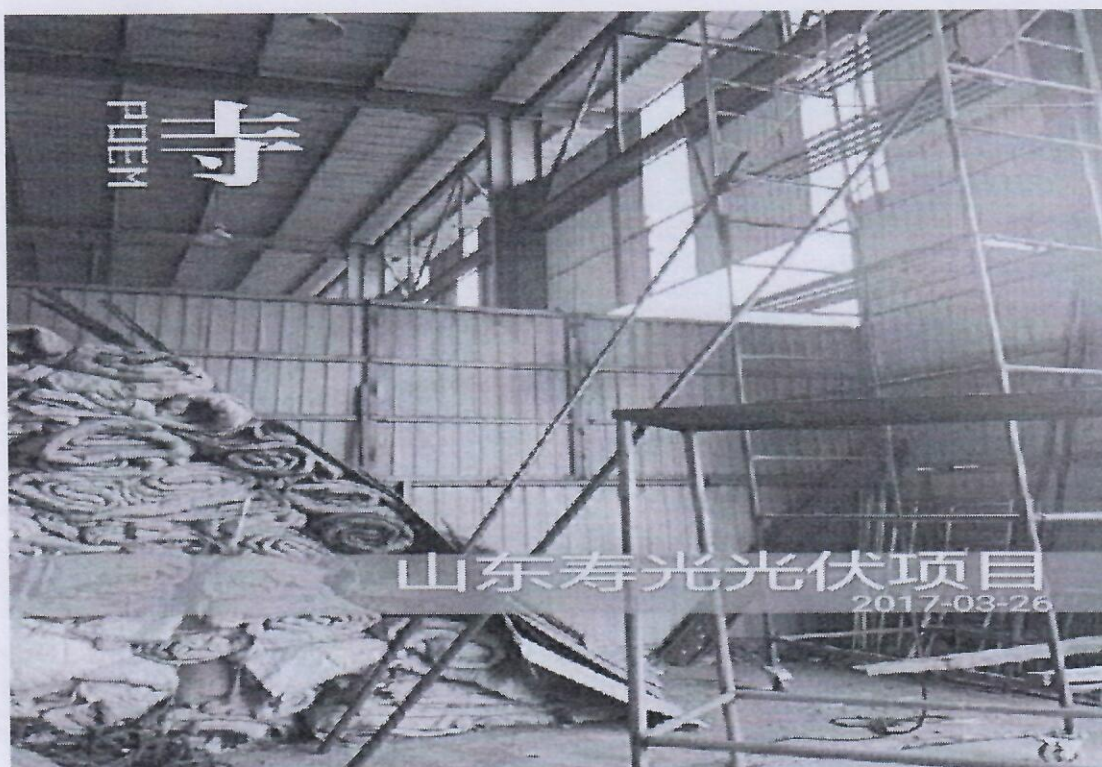
屋内没有防火覆盖，临时用电的电线凌乱。
